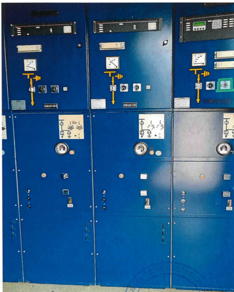
Ilustración 3 Vista Frontal de las Celdas 8DA10
